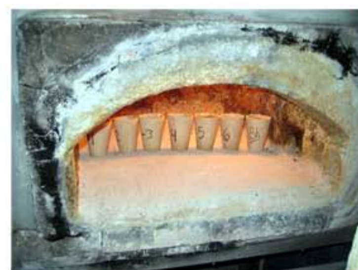
Foto 4: El horno requiere limpieza y debería operarse a aproximadamente 1100 C.
